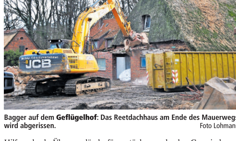
Bagger auf dem Geflügelhof: Das Reetdachhaus am Ende des Mauerwegs wird abgerissen. Foto Lohmann
